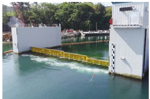
水門扉体浮上状況
