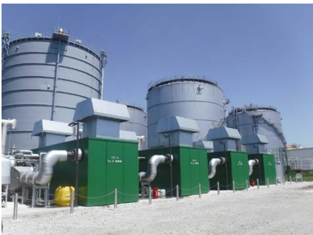
鋼板製消化タンクとバイオガス発電機
