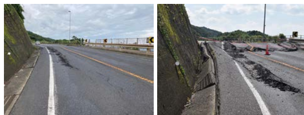
路面亀裂の変化
