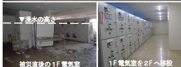
1F電気室を2Fへ移設 管理棟電気室を1階から2階に移設（耐水化対策）
